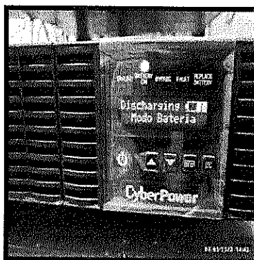
Prueba de baterías
